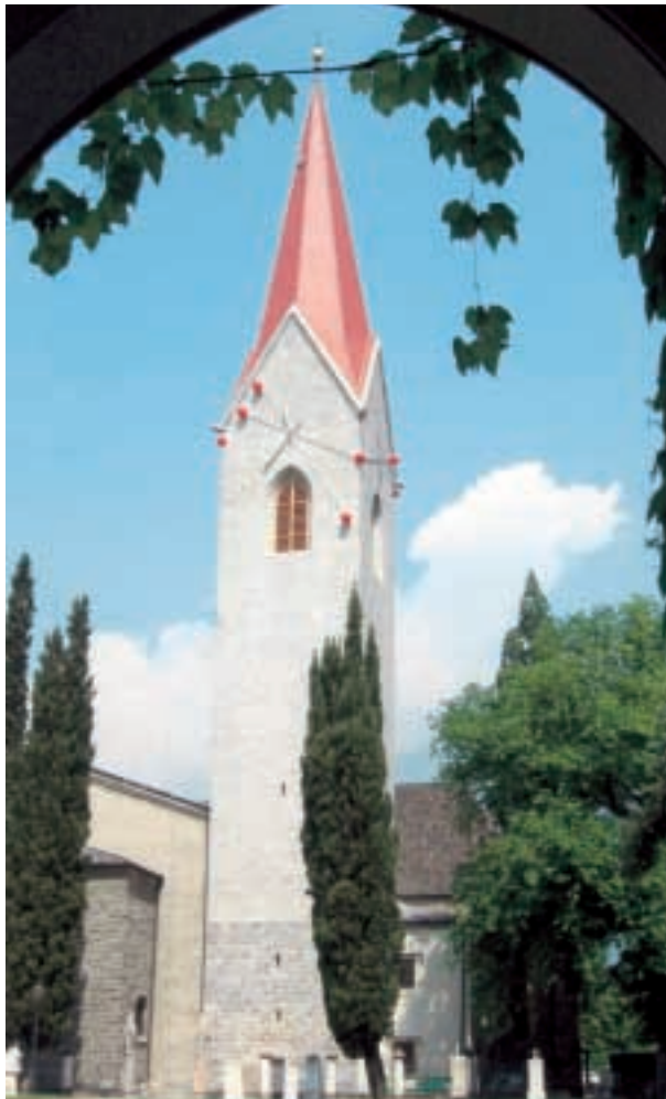
Dach und Mauerwerk des Turms der Pfarrkirche St. Vigil in Meran/Untermals wiesen schwere Schäden auf, die Turmuhr wurde allgemein als „unschön“ bezeichnet. Der Kirchturm ist inzwischen mit Mitteln der Stiftung Südtiroler Sparkasse aufwendig saniert worden, dessen Segnung fand an Fronleichnam 2002 statt.
