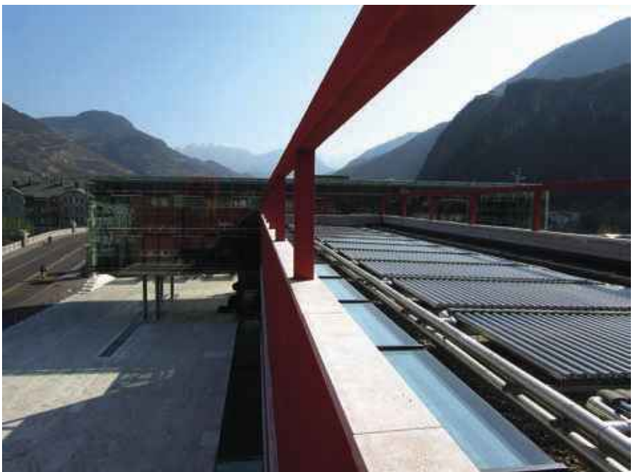
Anlage zur solarthermischen Kühlung auf dem Dach der EURAC: Ersatz für herkömmliche Klimaanlage
